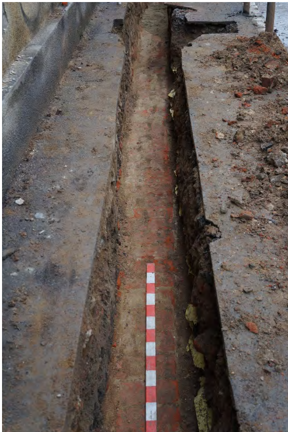
Fig. 7. Șanțul de poziționare a cablurilor cuprins între căminul nr. 2 și poarta de acces în curtea Spitalului Municipal (vedere spre Piața Mărăști). Pe fundul acestuia se poate observa zidul fortificației bastionare.
