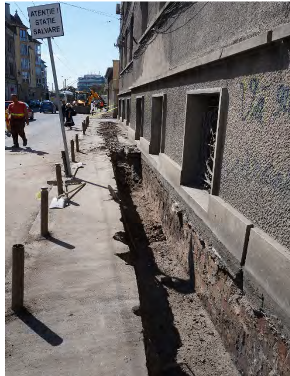
Fig. 8d. Șanțul de poziționare a cablurilor cuprins între poarta de acces în curtea Spitalului Municipal și Piața Mărăști, în care nu au fost identificate structuri ale fortificației bastionare.
