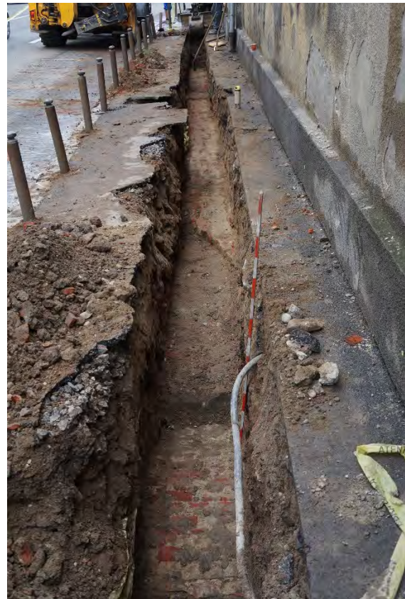
Fig. 8. Șanțul de poziționare a cablurilor cuprins între căminul nr. 2 și poarta de acces în curtea Spitalului Municipal (vedere dinspre Piața Mărăști). Pe fundul acestuia se poate observa zidul fortificației bastionare. În prim plan se observă o structură boltită.
