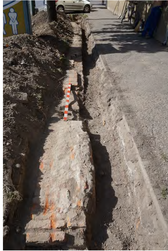
Fig. 16a. Șanțul de poziționare a cablurilor cuprins între Căminul nr. 7 și nr. 8 de pe strada Oituz, unde au fost identificate structuri zidite (vedere dinspre est). Detaliu.
