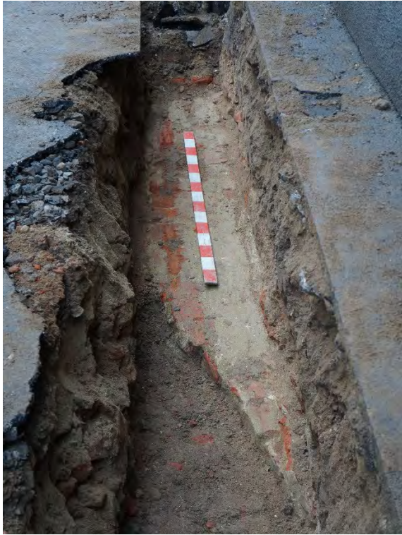
Fig. 8a. Șanțul de poziționare a cablurilor cuprins între căminul nr. 2 și poarta de acces în curtea Spitalului Municipal (vedere dinspre Piața Mărăști). Detaliul zidului fortificației bastionare, tăiat de un șanț modern.
