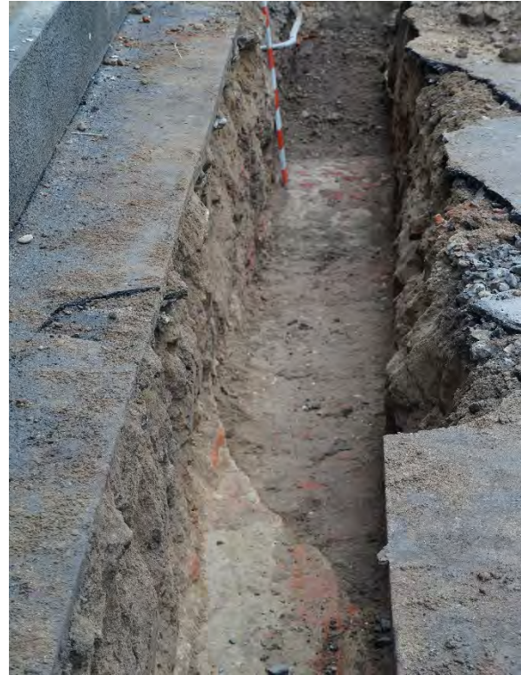
Fig. 8b. Șanțul de poziționare a cablurilor cuprins între căminul nr. 2 și poarta de acces în curtea Spitalului Municipal (vedere spre Piața Mărăști). Detaliul zidului fortificației bastionare, tăiat de un șanț modern, și a structurii boltite.
